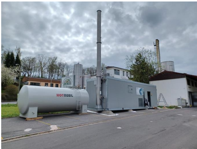
Mobiler Dampfcontainer einsatzbereit mit externer Tankanlage
