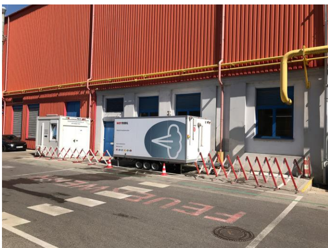
Fahrbare mobile Dampfzentrale im Einsatz
